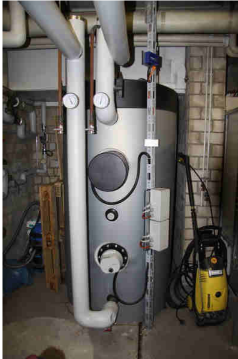
Bild 5: Warmwasserspeicher für das Hallenbad im BA 2
