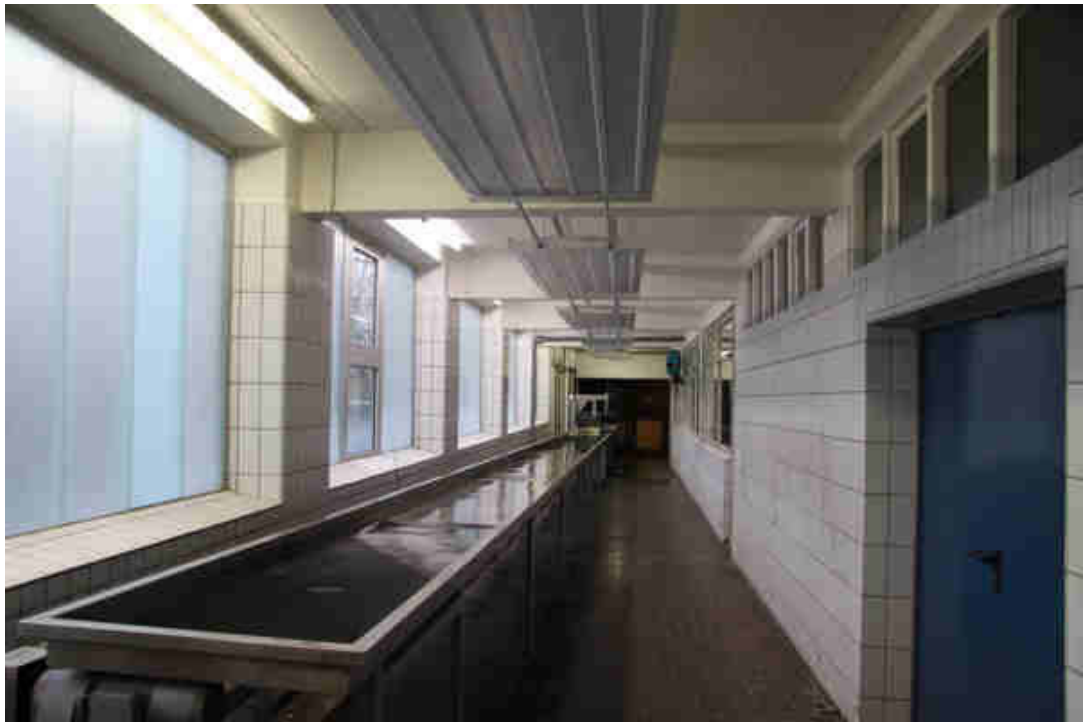
Bild 5: Raum für die Reinigung der Schläuche mit Deckenstrahlplatten für die Beheizung
