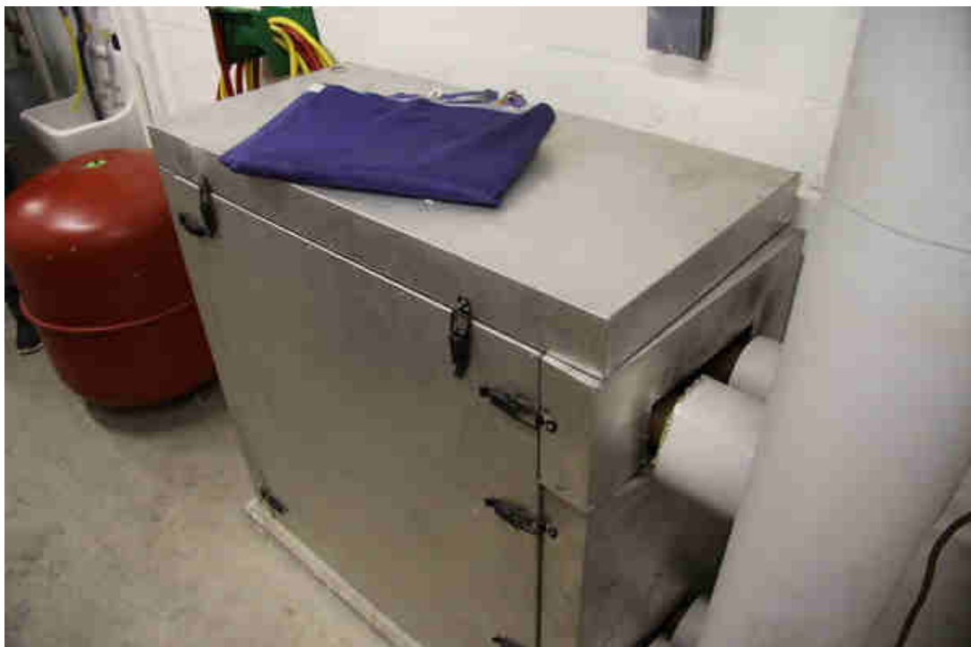
Bild 4: Wärmetauscher der Fernwärme für die Heizenergieversorgung des Gebäudes
