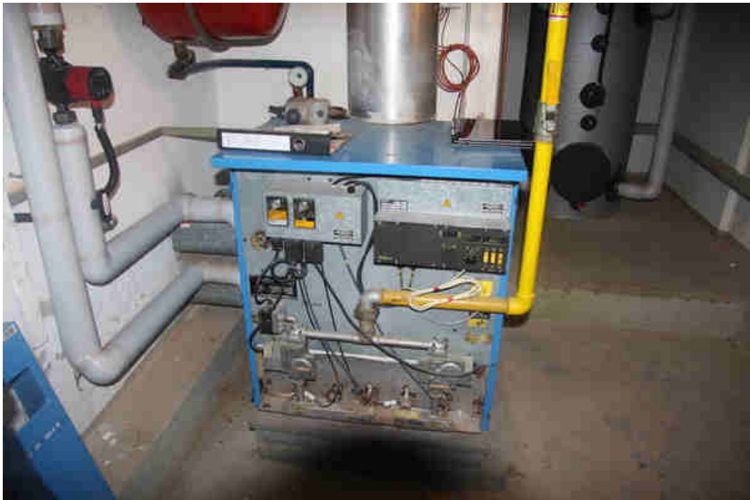
Bild 3: Niedertemperaturkessel für die Wärmeversorgung der Turnhalle mit Baujahr 1987
