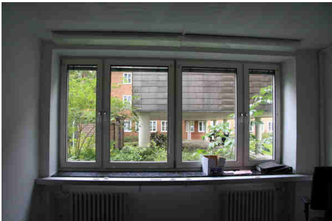
Bild 10: Fensteranlage in einem Büro
