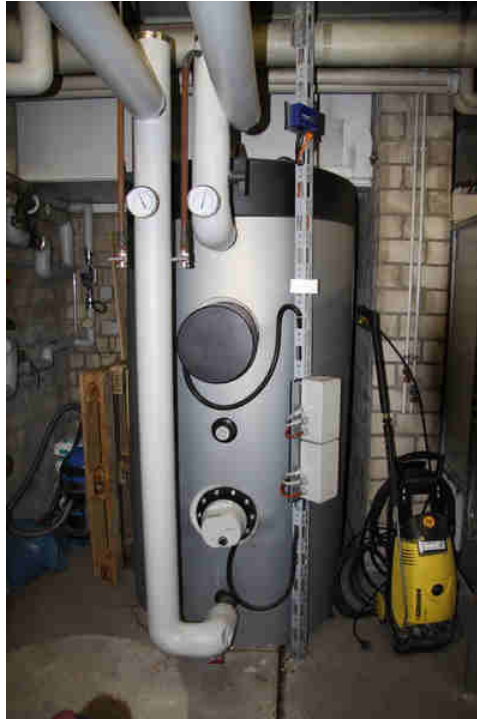
Bild 5: Warmwasserspeicher für das Hallenbad im BA 2
