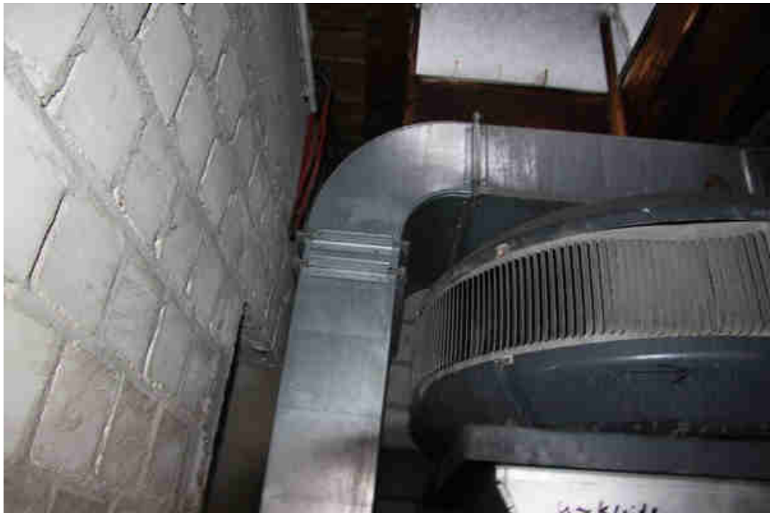
Bild 11: Lüftungsgerät im Dachgeschoß für das Schwimmbad im Untergeschoß
