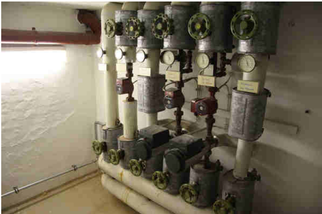
Bild 6: Heizungsverteilung mit alten Effizienzumpen und handgesteuerten 3-Stufen Drehzahlregelung
