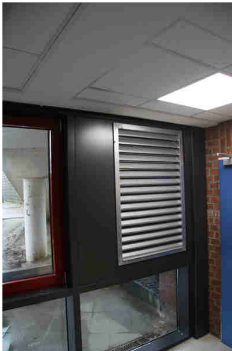
Bild 6: Rauchabzug im Flurbereich des Untergeschosses
