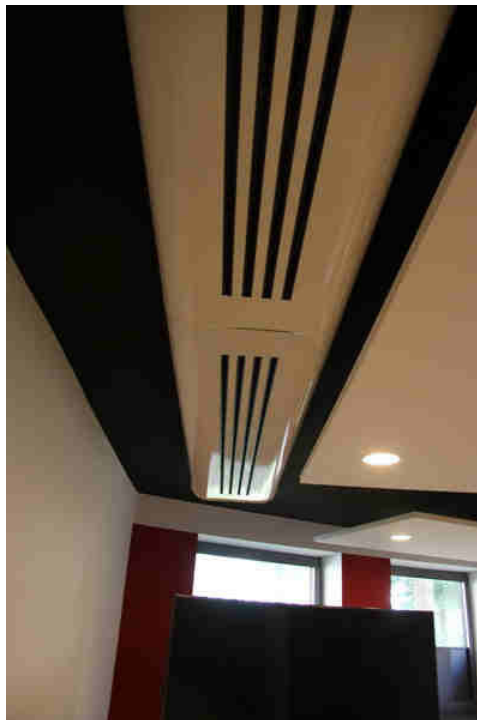
Bild 14: Lüftungskanäle für die Klimatisierung in den Besprechungsräumen des UG im KT-Gebäude
