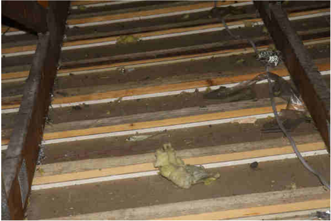
Bild 9: Teilweise ungedämmte oberste Geschoßdecke
