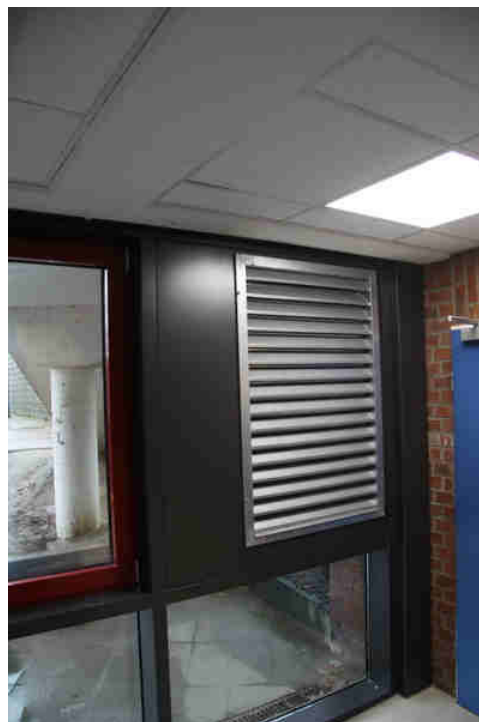
Bild 8: Rauchabzug im Flurbereich des Untergeschosses
