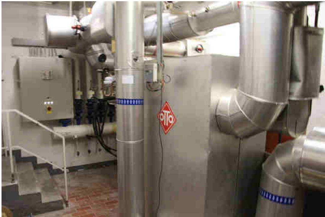
Bild 7: Fernwärmeanschluss mit Heizungssteuerung
