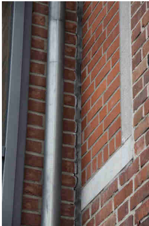
Bild 17: Schadhafter Fugenverschluss der Bauwerksfuge zwischen BA 1 und BA 2
