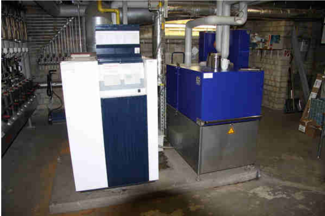
Bild 3: Brennwertkessel als Spitzenlastkessel und ein BHKW für die Stromerzeugung
