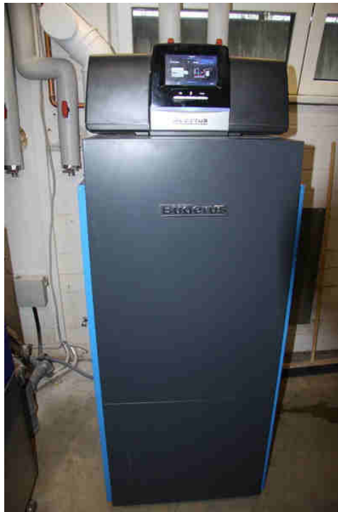
Bild 3: Neuer Heizkessel für die Wärmeversorgung
