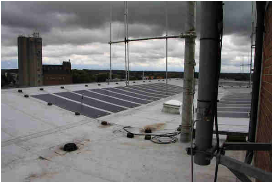
Bild 14: Flachdachfläche mit aufgeklebter Photovoltaik
