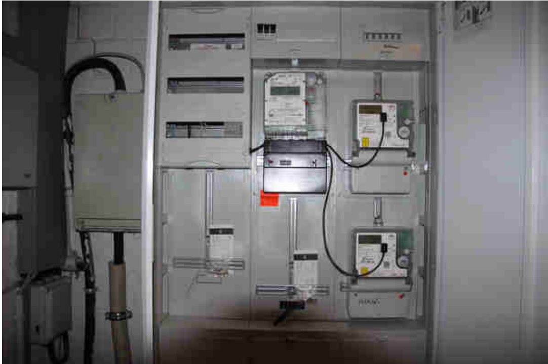
Bild 7: Stromzähler für den Verbrauch und Einspeisung ins Netz
