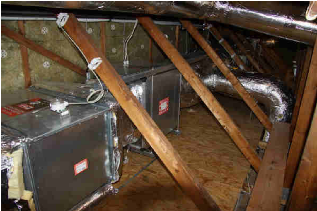
Bild 8: Lüftungsanlage für die Be- und Entlüftung sowie Klimatisierung des Gebäudes
