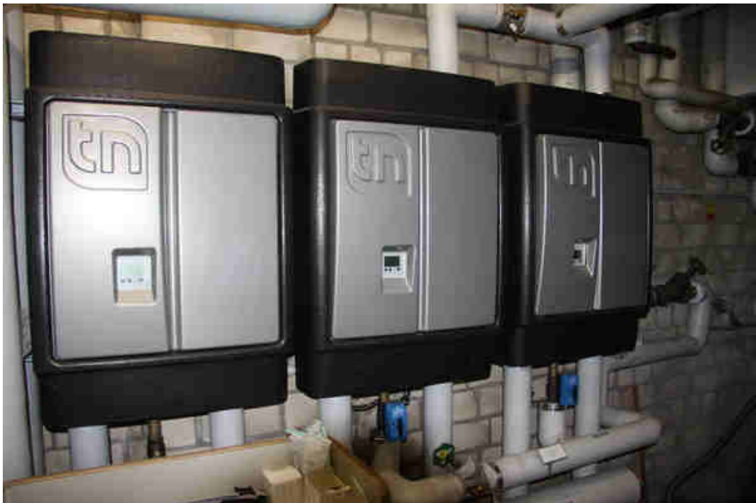
Bild 4: Frischwasserstationen für die Warmwasserversorgung
