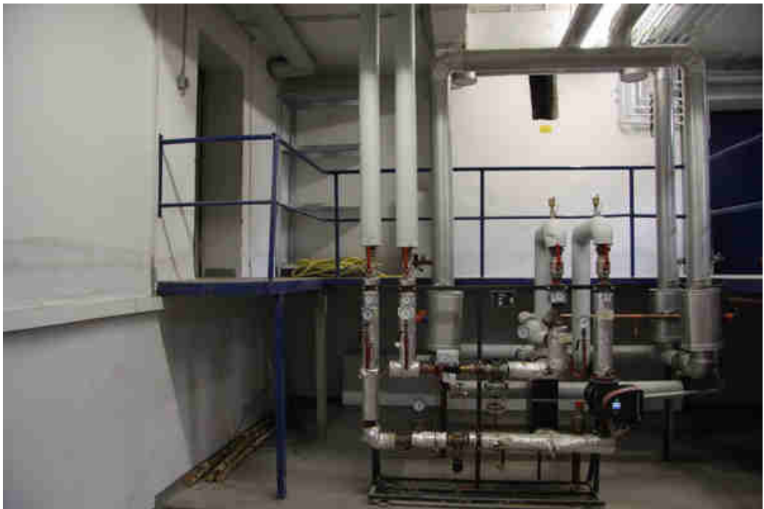
Bild 10: Heizungsraum mit Fernwärmeanschluss
