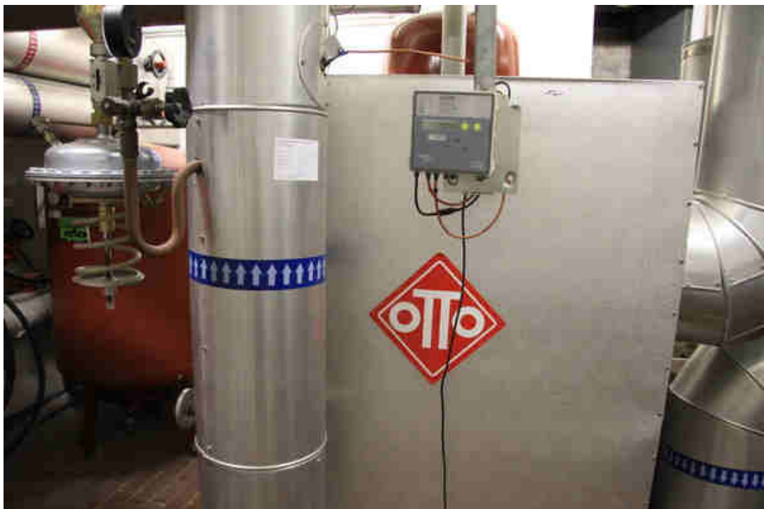
Bild 6: Fernwärmeanschluss mit Verbrauchszähler
