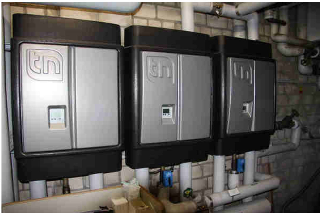
Bild 4: Frischwasserstationen für die Warmwasserversorgung
