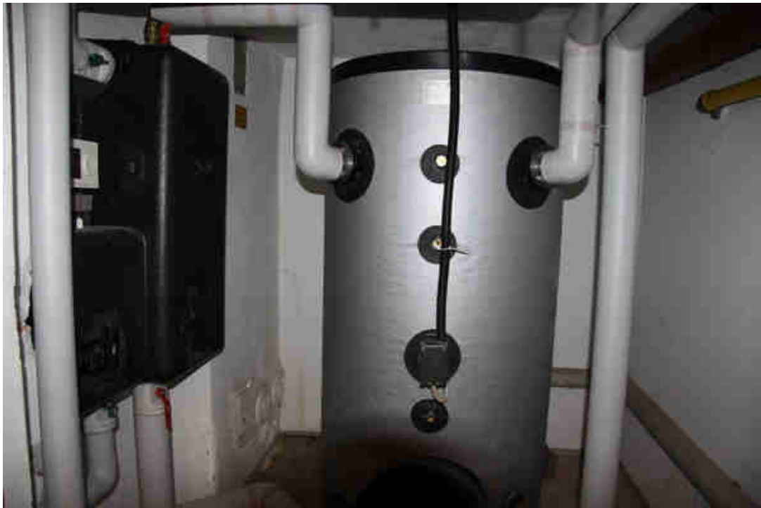
Bild 5: Warmwasserspeicher der Turnhalle
