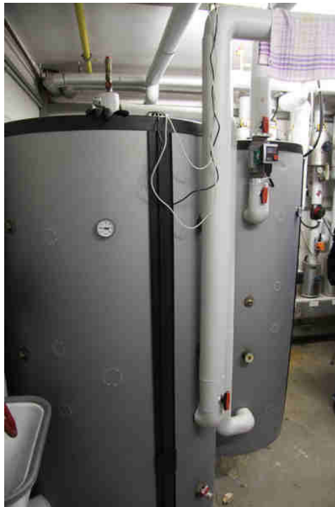
Bild 5: Wärmespeicher für die Speicherung der Abwärme des BHKW's
