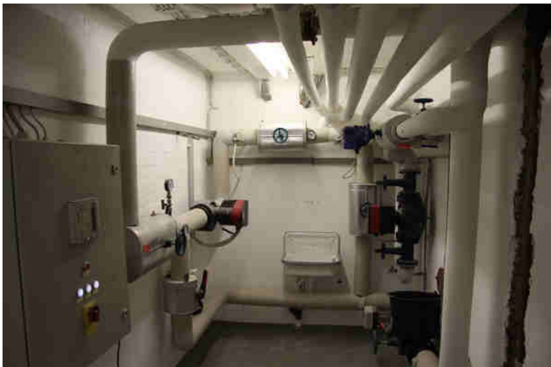
Bild 12: Heizungsverteilung für Gebäude C und KT
