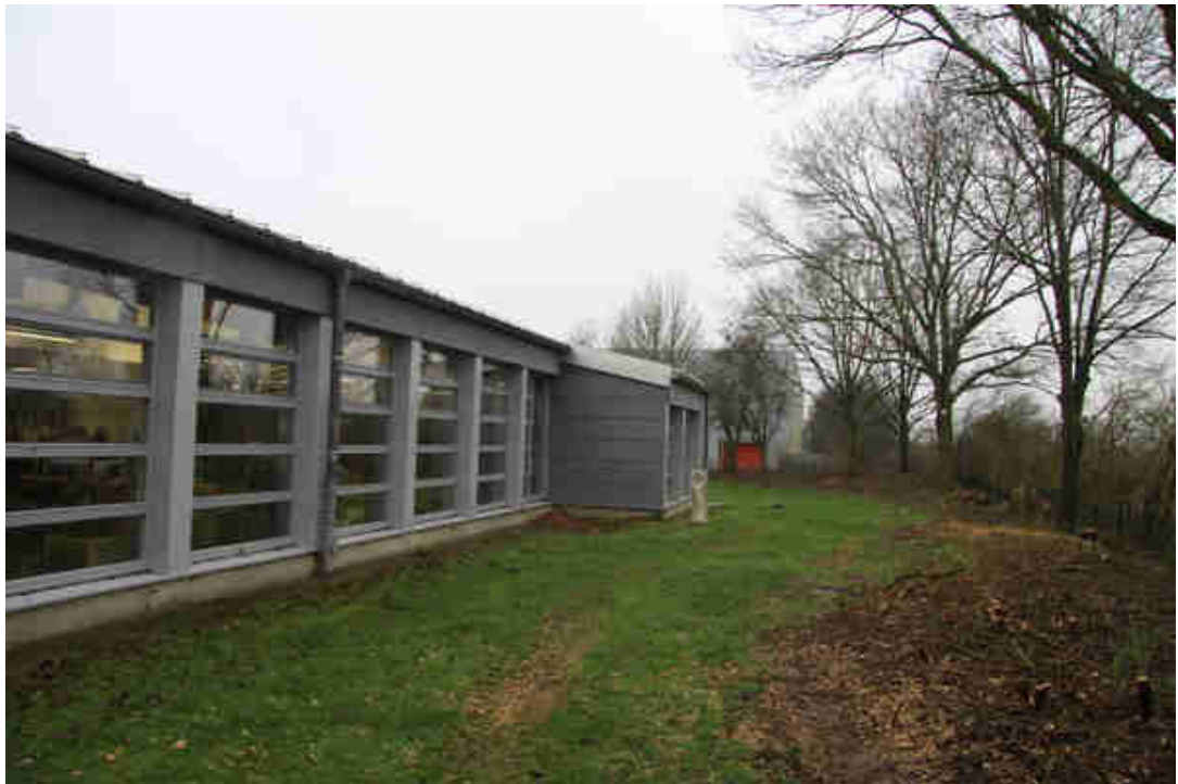
Bild 11: Ansicht auf die Nordseite des Gebäudes mit Wärmebrücke im unteren Bereich der Fensteranschlüsse
