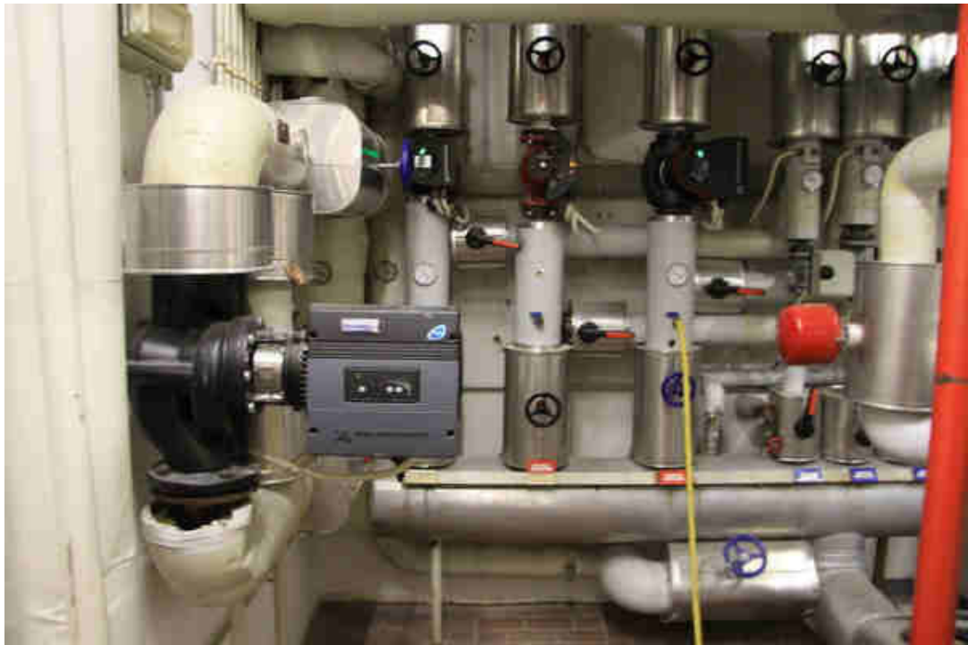
Bild 9: gedämmte Heizungsverteilung mit Effizienzpumpen und Stellantrieben
