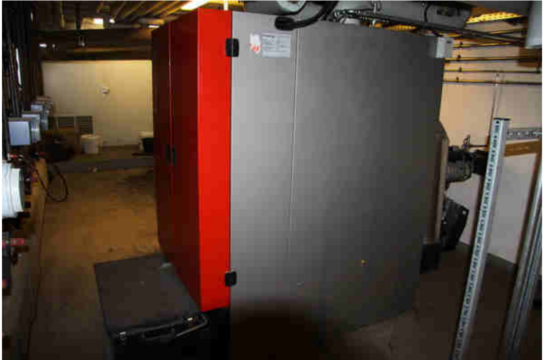
Bild 3: Pelletkessel für die Heizenergieversorgung der gesamten Liegenschaft
