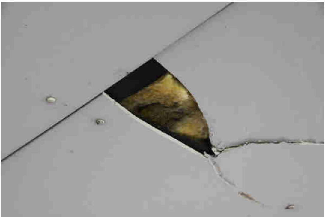
Bild 14: Beschädigte Deckenverkleidung am Verbindungsgang A-B
