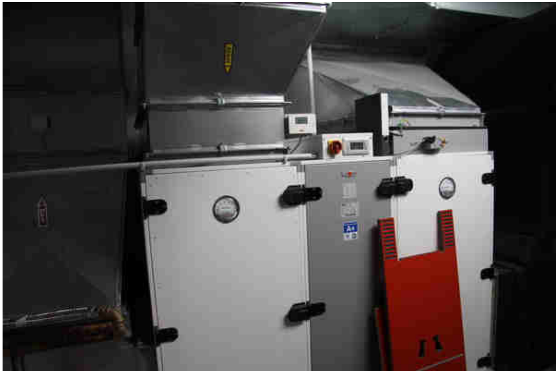
Bild 13: Klimagerät für das KT-Gebäude
