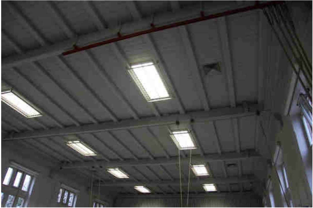
Bild 9: Hallenbeleuchtung mit LED
