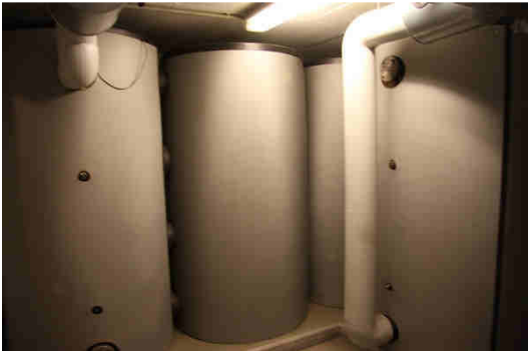
Bild 4: Pufferspeicher für den Pelletkessel
