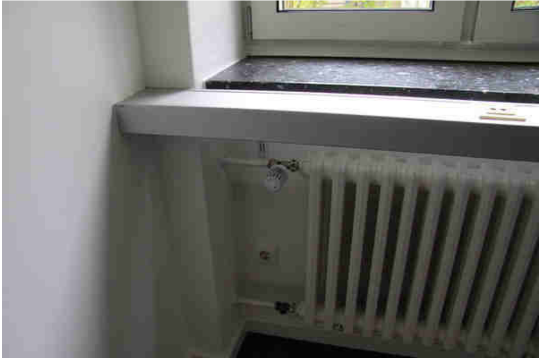
Bild 11: Heizköpernische mit Gussrippenheizkörper
