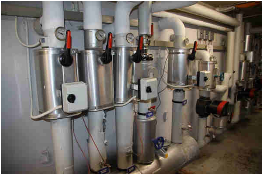
Bild 7: Heizungsverteilung für das Gebäude A im Untergeschoss
