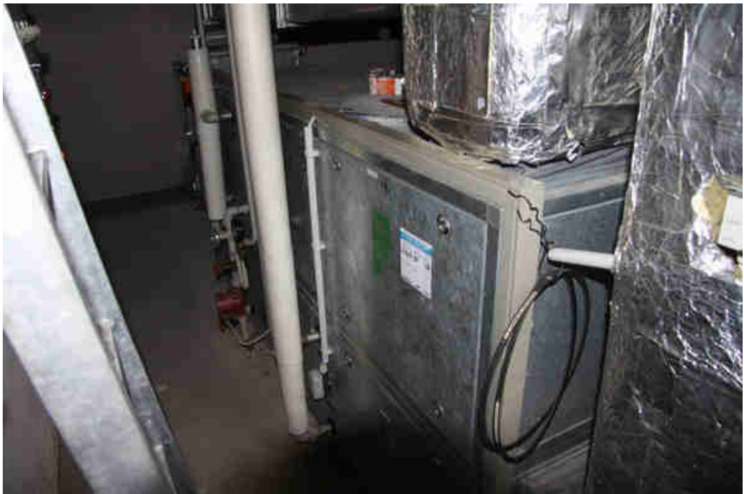
Bild 10: Alte Lüftungsanlage von 1982
