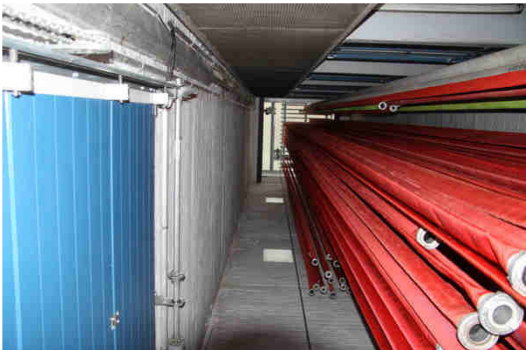
Bild 6: Schlauchturm zum Trocknen der gereinigten Schläuche
